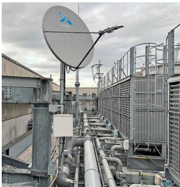
■図4. 屋外に常設されている衛星アンテナ（屋上）
