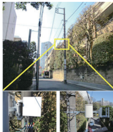
■図5. 電柱への設備設置の一例
