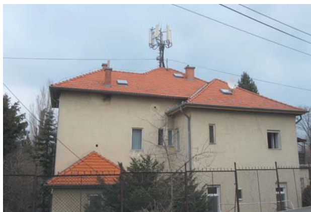
写真4. 民家の屋根に設置された携帯電話の基地局 (筆者撮影)
