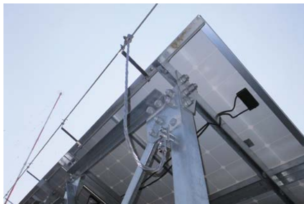
写真5. 太陽光パネル用避雷設備
