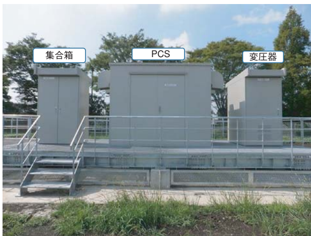
写真6. 屋外電源設備
