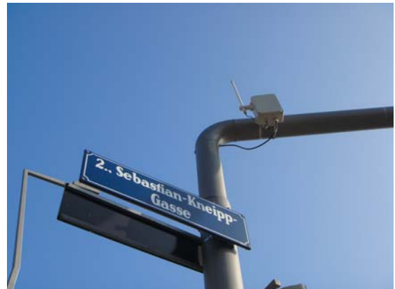
写真5. デモ用に設置された路側アンテナ
