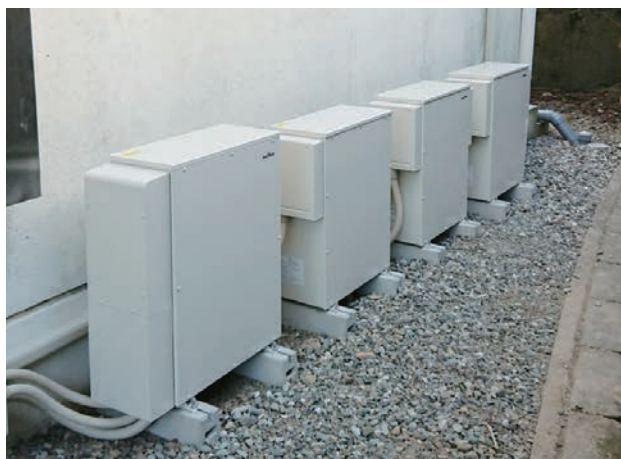
■図5. 設置された蓄電池(村田製作所製)
