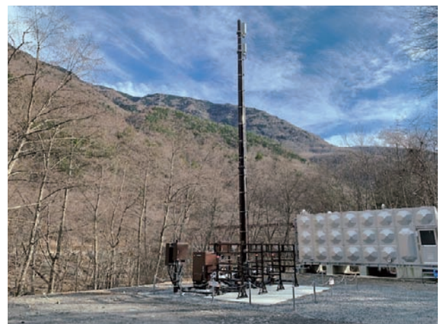
■図3. 地方エリアの新設鉄塔
