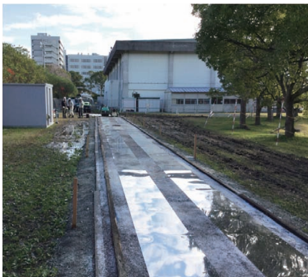
(a) 鉄板レール埋設工程 (この上をアスファルトで全面舗装する)
