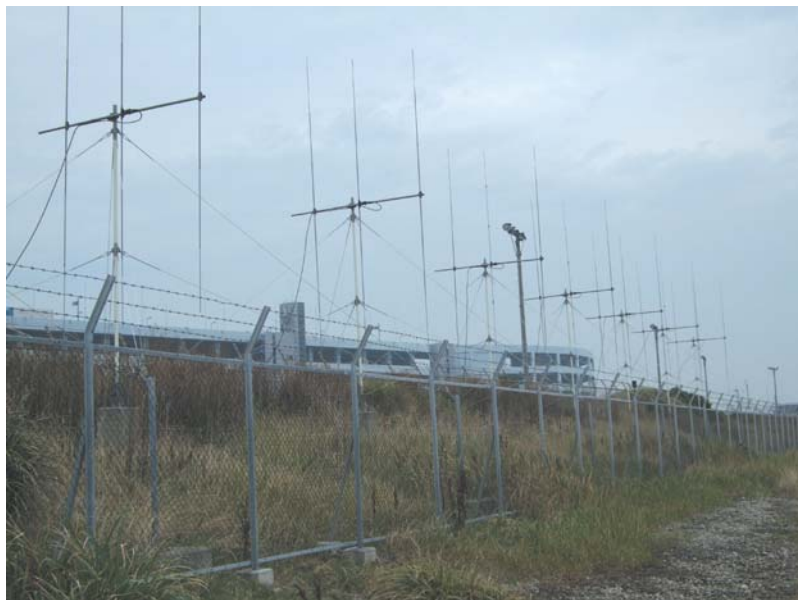
写真1. 沿海に設置されている海洋レーダー (神奈川県横浜市)
